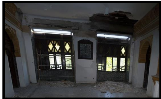
صورة 61: انهيار سقف احدى الغرف
